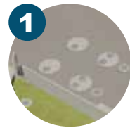
1 Elevatória de Esgoto Bruto Envia todo o esgoto coletado para o início do tratamento
