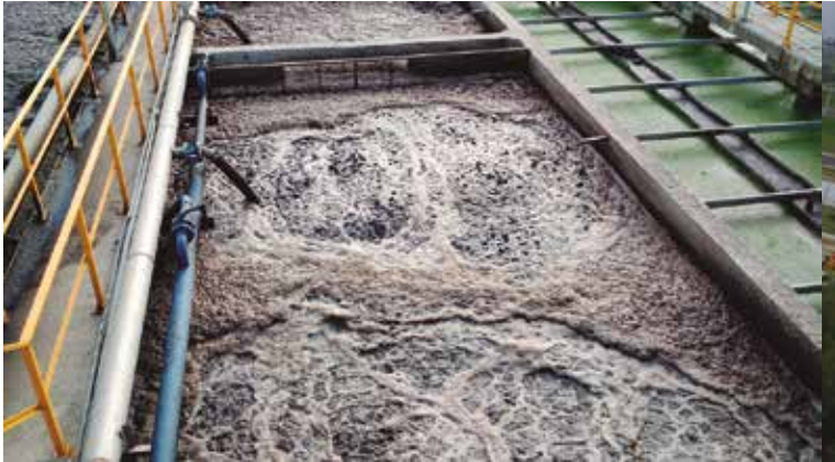
Foto ETE Itaipu - Reator Aeróbio
