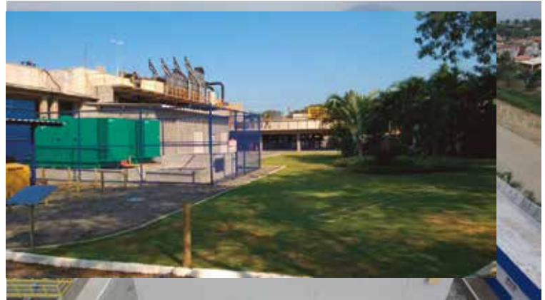
Foto ETE Itaipu - Geradores, preliminar integrado e flutador ao fundo
